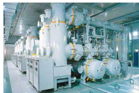
27万5千ボルト ガス絶縁開閉装置
